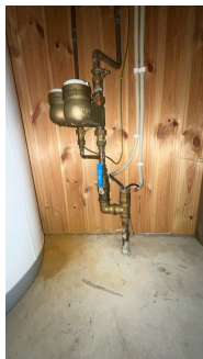
Stoppekran er plassert i bod i underetasje.
