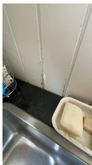
Fuktskade på kledning ved utslagsvask.
