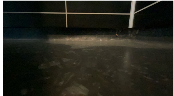
Våtromsplater mangler bunnprofil.
