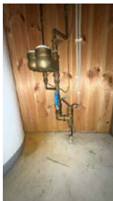
Stoppekran er plassert i bod i underetasje.
