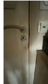
Dørene bærer preg av brukslitasje, men ivaretar funksjonskrav.
