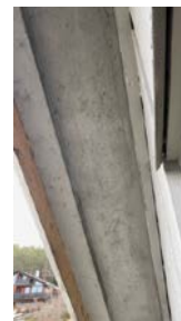
Misfarging på undertak på takutstikk
