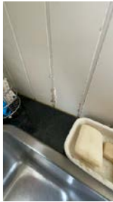
Fuktskade på kledning ved utslagsvask.
