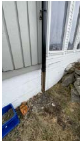
Det er ikke tilfredsstillende bortledning av vann fra taknedløp ved grunnmur. Malings/folieflask registrert.
