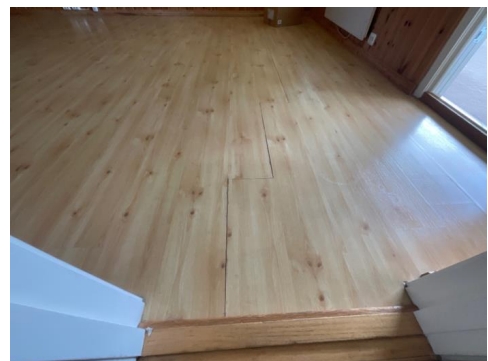
Spekk i skjøt på laminatgulv i stuen
