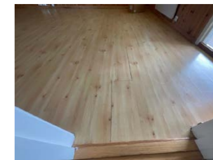
Spekk i skjøt på laminatgulv i stuen
