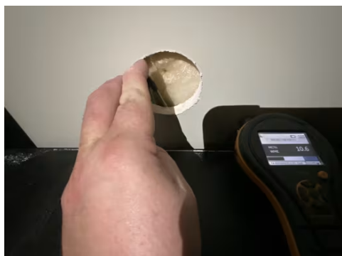
Hulltaking i nedre del av påforet vegg under terreng. Målingen viser 10.6%, dette er en godkjent verdi.
