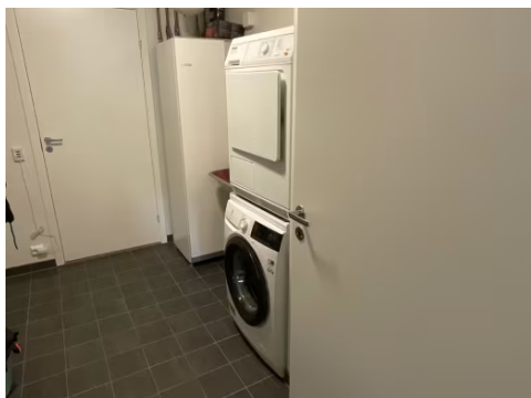
Vaskerom med fliser på gulv og malt strie på vegg. Utslagsvask og opplegg for vaskemaskin.
