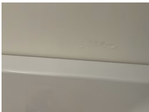
To småskader i strietapet ved badekar, disse stammer fra et stellebord. Punkter har blitt forseglet med våtromsmaling.
