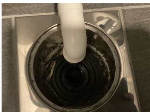
Plastsluk med synlig klemring og membran.
