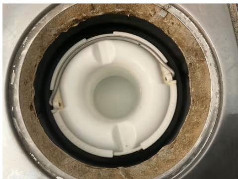
Sluk i dusjsonen. Plastsluk med synlig membran, men klemring er skjult av fliselim.
