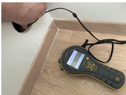
Hulltaking fra tilstøtende rom, målingen er utført i vegg bak dusjsone. Målingen viser ingen tegn til fukt i konstruksjonen.
