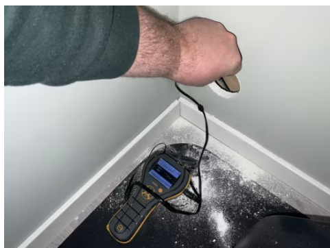
Hulltaking utført fra tilstøtende rom, målingen er utført i vegg bak dusj. Målingen viser ingen tegn til fukt i konstruksjonen.
