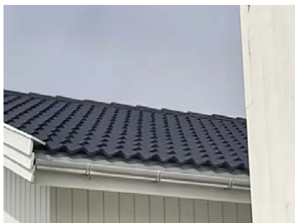
Det er manglende snøfanger på tak der folk ferdes.
