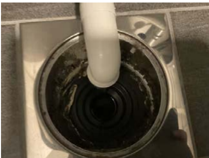
Plastsluk med synlig klemring og membran.
