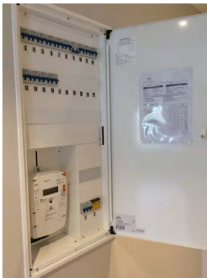
Komplett nytt elektrisk anlegg i leiligheten.
