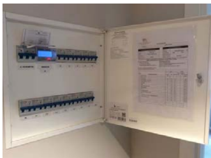
Eget sikringsskap med minusmåler i underetasje.
