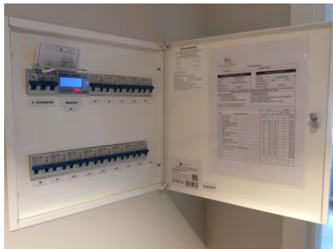
Eget sikringsskap med minusmåler i underetasje.
