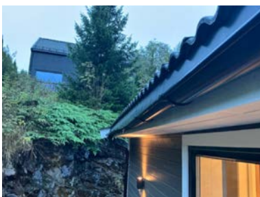
Nedbøying i takrenne.
