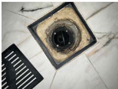
Mangler jording i sluk.
