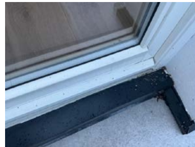
Beslag er ikke riktig montert.
