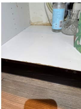
Bilde viser slitasje og svelling på kjøkkenskrog.
