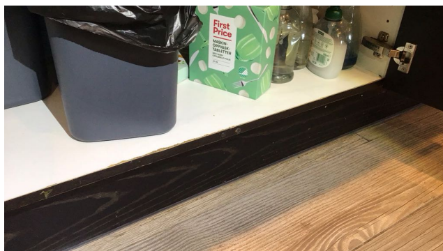
Bilde viser slitasje og svelling på kjøkkenskrog.
