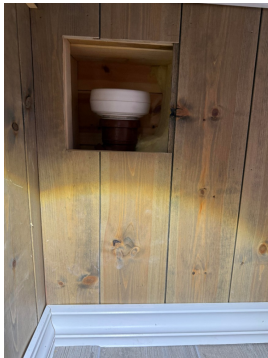
Bilde av vakumventil på avløpssystemet.
