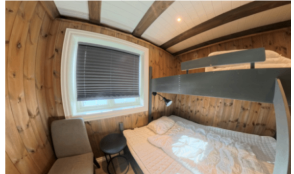
Bildet viser et av soverommene uten ventilasjon, kun med åpningsbare vinduer.
