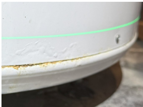
Bildet viser noe som kan se ut som rustblekker på varmtvannsberederen.
