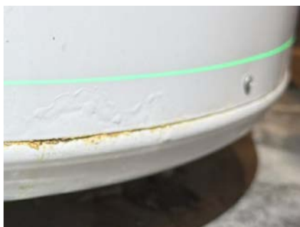
Bildet viser noe som kan se ut som rustblemmer på varmtvannsberederen.
