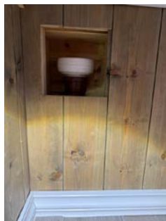
Bilde av vakumventil på avløpssystemet.
