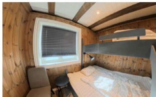
Bildet viser et av soverommene uten ventilasjon, kun med åpningsbare vinduer.
