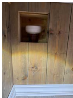
Bilde av vakumventil på avløpssystemet.
