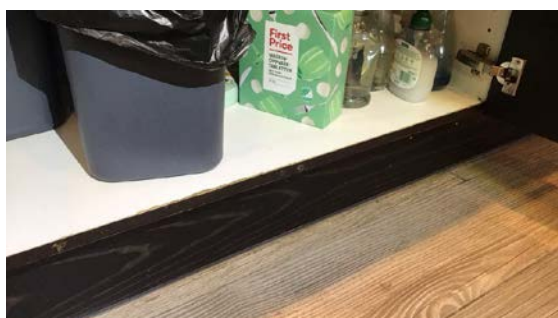
Bilde viser slitasje og svelling på kjøkkenskrog.
