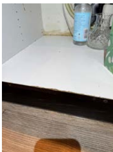
Bilde viser slitasje og svelling på kjøkkenskrog.
