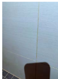
Bildet viser misfarging av flisfuger.
