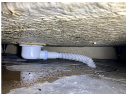
Vann på gulv under dusjgulv.
