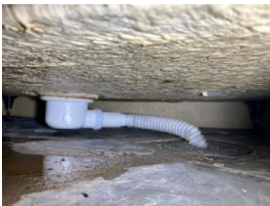
Vann på gulv under dusjgulv.
