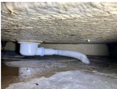
Vann på gulv under dusjgulv.
