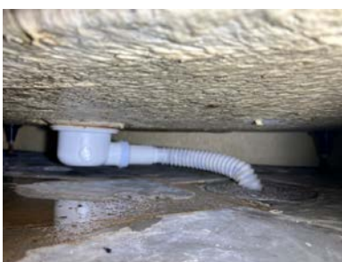
Vann på gulv under dusjgulv.
