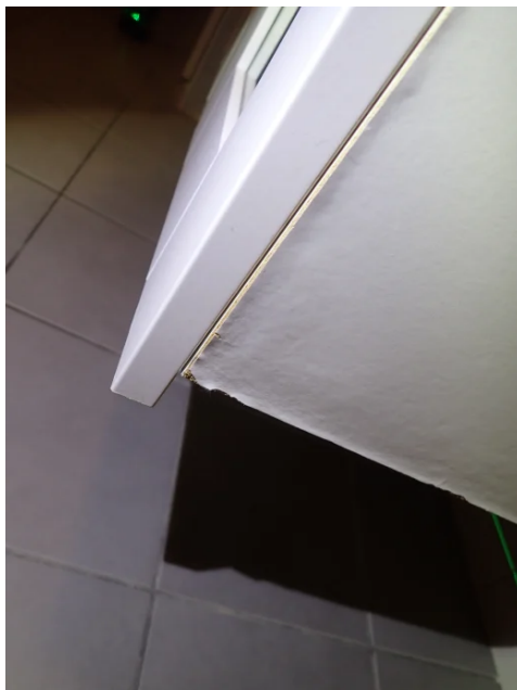
Fuktskader/svelling på baderomsinnredningen.
