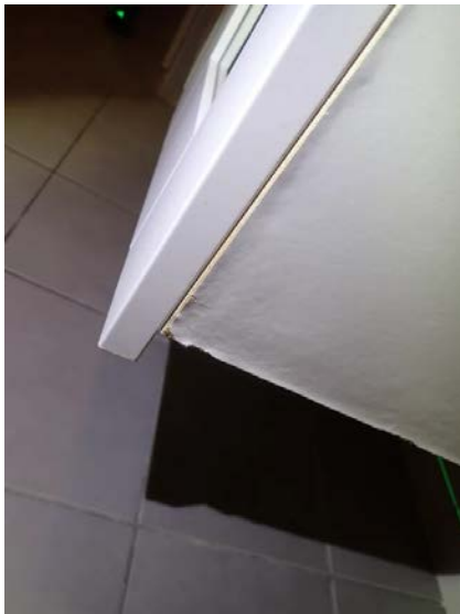
Fuktskader/svelling på baderomsinnredningen.
