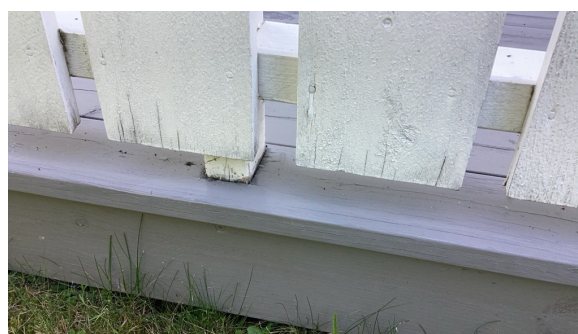
Eksempel på sprekker i kledningsbord.
