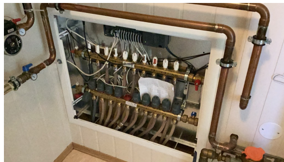
Fordelerskap for vannrør for gulvvarme.
