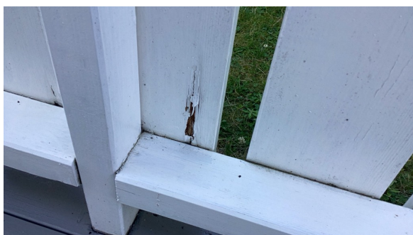
Eksempel på råte i kledningsbord.
