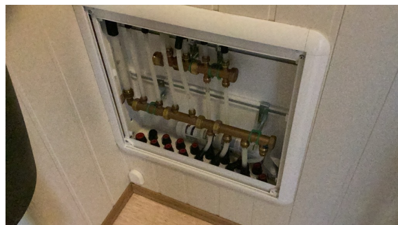
Fordelerskap for vannrør.
