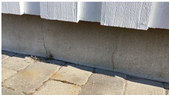
Eksempel på sprekker i grunnmursplater.
