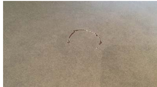
Skade på benkeplate.
