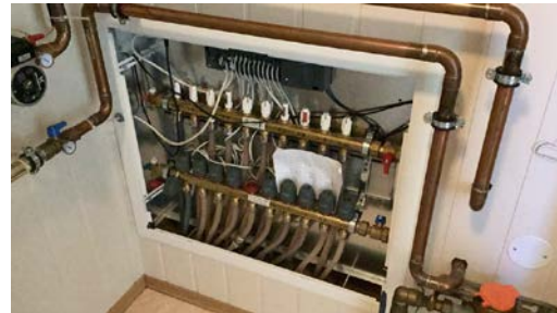
Fordelerskap for vannrør for gulvvarme.
