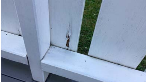
Eksempel på råte i kledningsbord.
