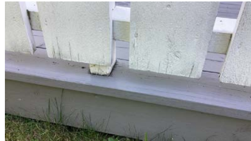
Eksempel på sprekker i kledningsbord.
