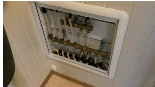
Fordelskap for vannrør.
