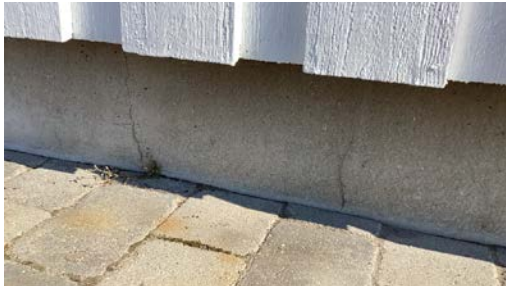
Eksempel på sprekker i grunnmursplater.
