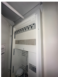
Sikringsskap med automatsikringer.
