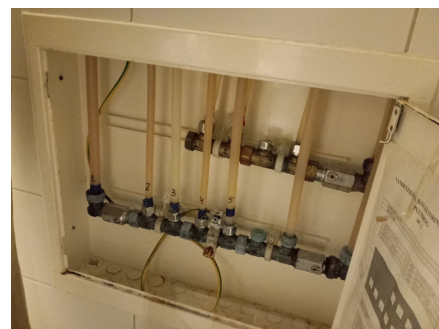
Samleskap med rørkurser og stoppekraner
