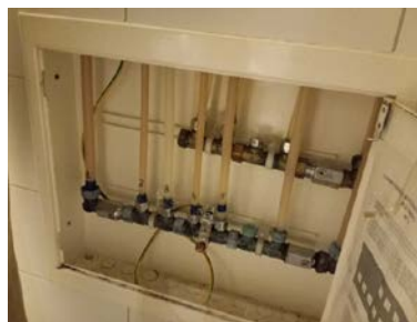
Samleskap med rørkurser og stoppekraner
