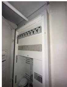
Sikringsskap med automatsikringer.
