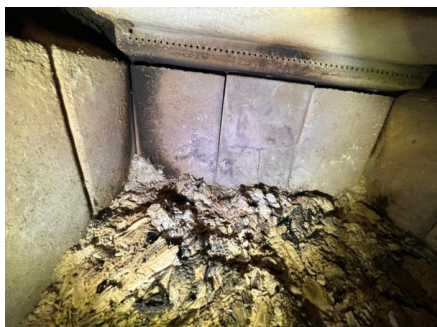
Sprekker i ildfast stein
