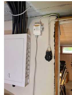
Avløp fra fordelerskap er ikke montert.
