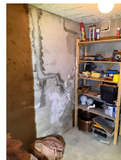
Sprekk som er tettet på innside.
