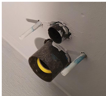
Vann og avløp til toalett
