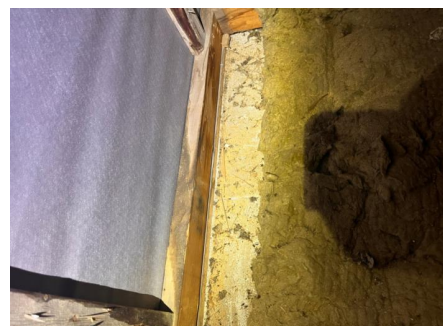
Ikke isolert på topp av murvegg
