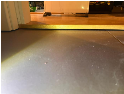
Ikke oppkant under dør
