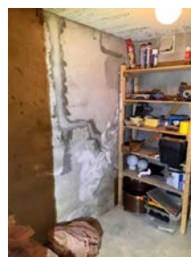
Sprekk som er tettet på innside.
