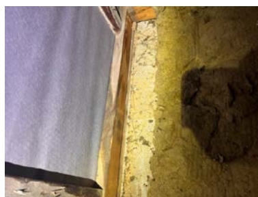
Ikke isolert på topp av murvegg
