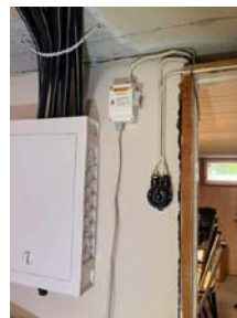
Avløp fra fordelerskap er ikke montert.
