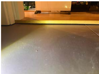
Ikke oppkant under dør
