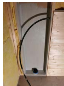
Vannnett kasse i vegg for vannsisterne toalett
