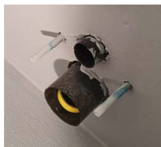
Vann og avløp til toalett
