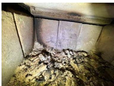
Sprekker i ildfast stein
