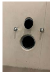
Tettet rundt vann og avløp på toalett etter befarings
