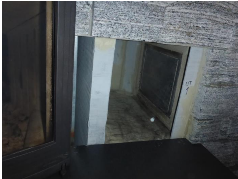
Viser skjult sotluke.
