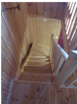
Viser trapp med manglende håndløper.
