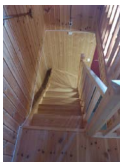
Viser trapp med manglende håndløper.
