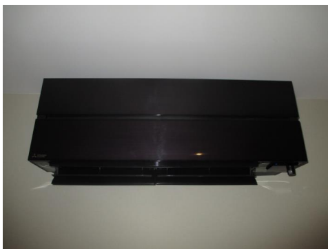
Varmepumpe i stue.
