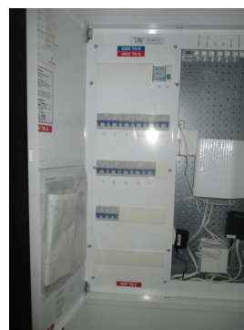
Sikringsskapet er plassert på vaskerommet.
