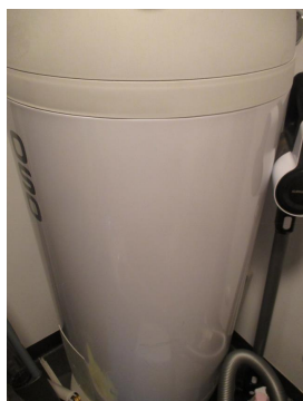
Bereder er plassert i bod/teknisk rom.
