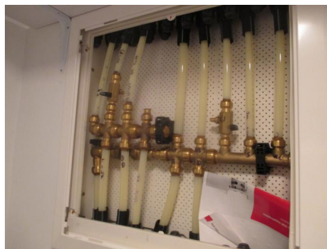
Fordelerskap i bod/teknisk rom.
