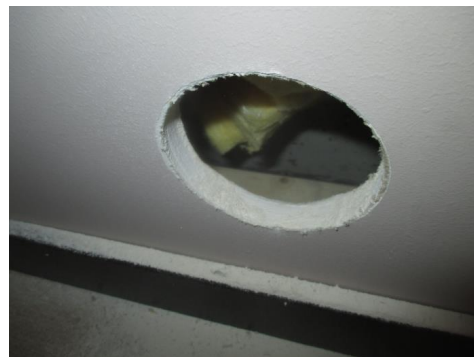
Hulltaking i utforede vegg på ene soverommet.
