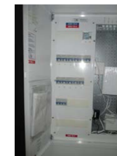
Sikringsskapet er plassert på vaskerommet.
