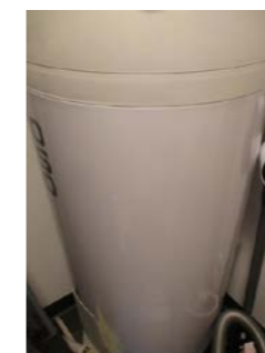
Bereder er plassert i bod/teknisk rom.
