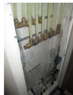
Hovedskapet i hall i underetasjen. Her er også vannmåler og innvendig stoppekran.
