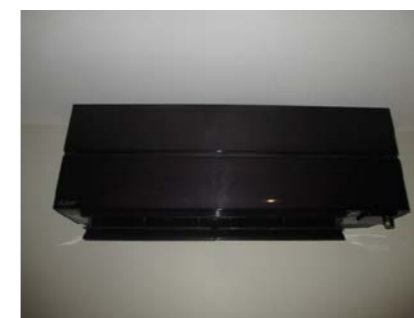
Varmepumpe i stue.
