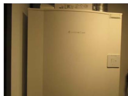
Selve enheten er plassert i bod/teknisk rom.
