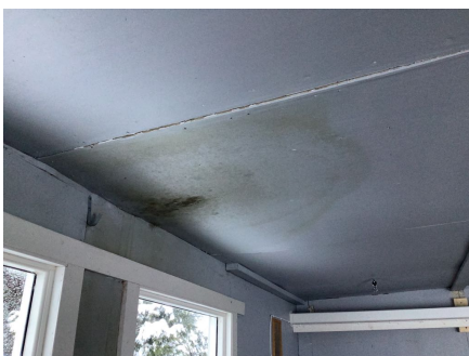
Fuktskadet gipsplate i himling i garasjen.
