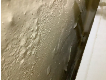
Saltutslag på åpen grunnmur.
