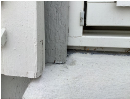
Omramming rundt vindu er ført helt ned til vannbrett.
