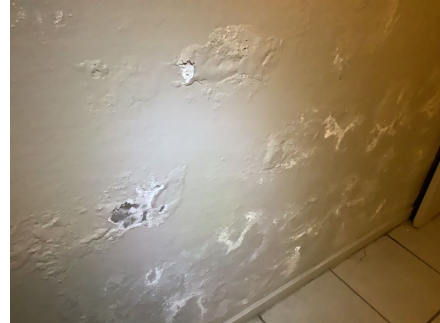
Saltutslag på åpen murvegg.
