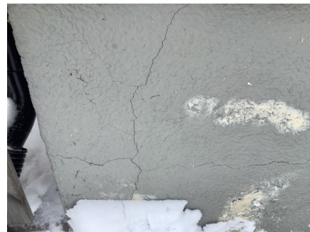
Utvendige skrå- og horisontalriss.
