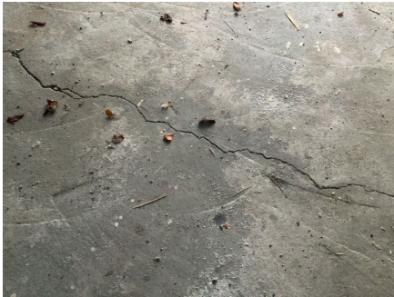
Eksempel på sprekkdannelse i betonggulv.
