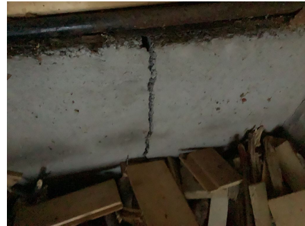
Eksempel på sprekkdannelse i ringmur.
