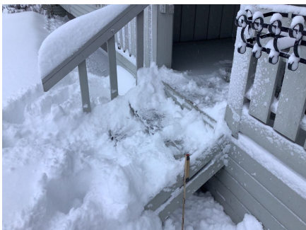
Trapp mangler rekkverk.
