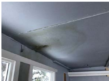
Fuktskadet gipsplate i himling i garasjen.
