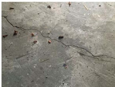
Eksempel på sprekkdannelse i betonggulv.
