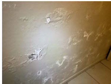
Saltutslag på åpen murvegg.
