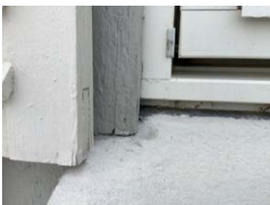
Omramming rundt vindu er ført helt ned til vannbrett.
