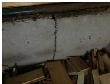
Eksempel på sprekkdannelse i ringmur.
