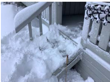
Trapp mangler rekkverk.
