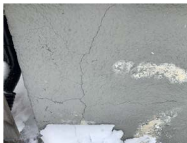
Utvendige skrå- og horisontalriss.
