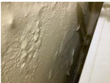
Saltutslag på åpen grunnmur.
