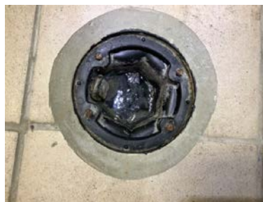
Plastsluk, og det er ikke synlig tettesjikt rundt sluk.
