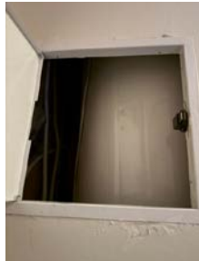
Varmtvannsbereder bak luke i trappeoppgang.
