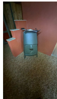
Ildfast plate mangler på gulvet under/foran ildstedet.
