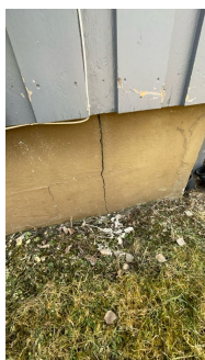
Sprekker/riss ble registrert på grunnmur.
