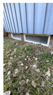
Lav høyde mellom terreng og kjellervinduer.
