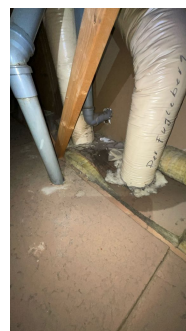
Fuktmerker rundt ventilasjonskanal.
