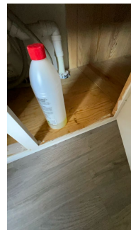
Fuktskjolder/svelling i bunnplate i benkeskap.
