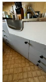
Kjøkkeninnredning bærer preg av slitasje.
