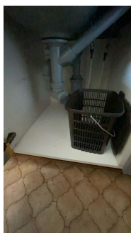
Fuktskjolder/svelling i bunnplate i benkeskap.
