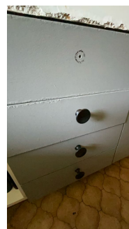
Kjøkkeninnredning bærer preg av slitasje.
