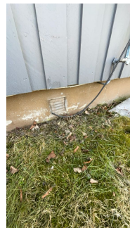
Småskader på grunn av fuktbelastning over tid.
