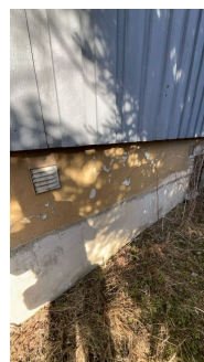
Småskader på grunn av fuktbelastning over tid.
