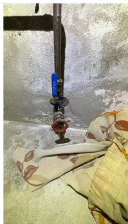
Stoppekran er plassert i bod i kjeller.
