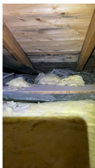
Synlig missfarging på undertak nede ved raft
