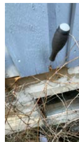
Det er påvist spredte råteskader i bordkledningen.
