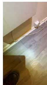
Skjøt på laminat har sklid fra hverandre.
