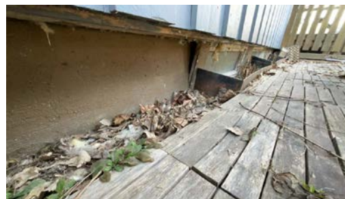
Vinduer i kjeller har sklid i ut, må ses i sammenheng med grunnmur.
