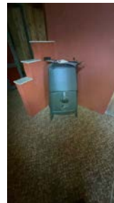
Ildfast plate mangler på gulvet under/foran ildstedet.
