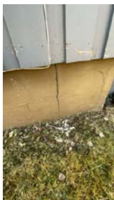
Sprekker/riss ble registrert på grunnmur.
