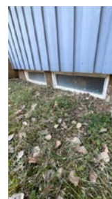
Lav høyde mellom terreng og kjellervinduer.
