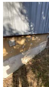
Småskader på grunn av fuktbelastning over tid.
