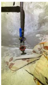
Stoppekran er plassert i bod i kjeller.
