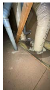
Fuktmerker rundt ventilasjonskanal.
