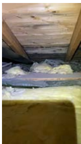
Synlig missfarging på undertak nede ved raft
