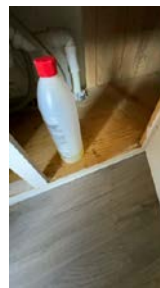
Fuktskjolder/svelling i bunnplate i benkeskap.
