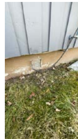
Småskader på grunn av fuktbelastning over tid.
