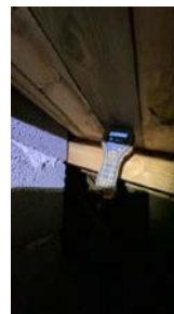
Det er usikkert om fuktmerker skyldes eldre eller nyere vanngjennomtrengning. Tilgjengelige merker var tørre på befaringen. Ved enkel fuktmåling registrerte jeg tørre verdier.
