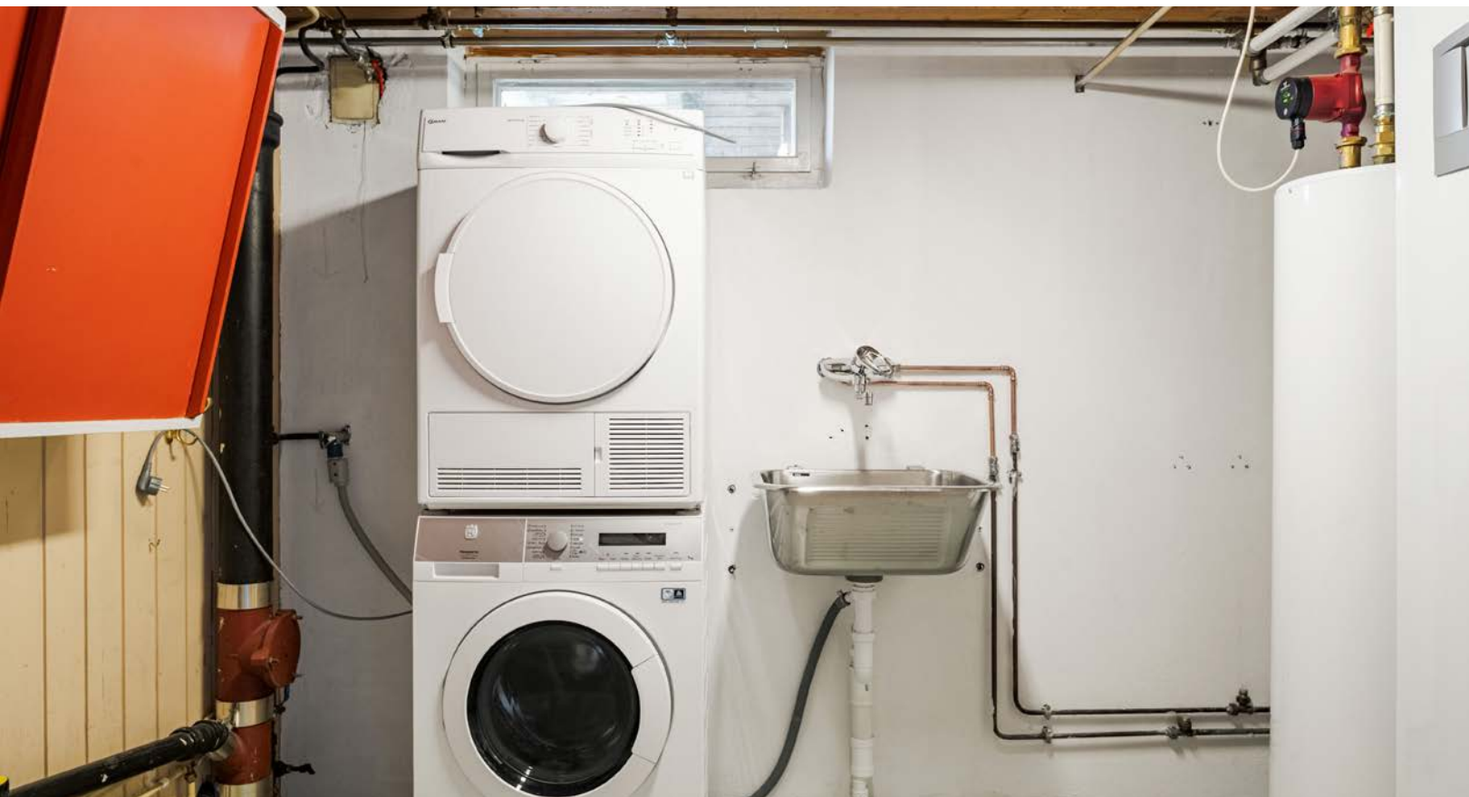
I kjelleren er det også et vaskerom med støpt gulv med sluk, utslagskum og opplegg for vaskemaskin/tørketrommel.
