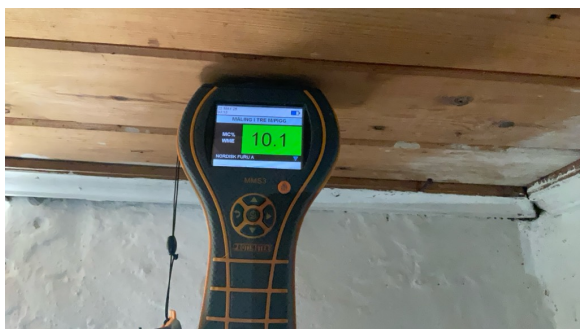
Fuktmåling i tak i kjelleren.
