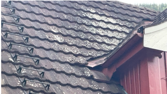
Stidmessig slitasje på taktekke.
