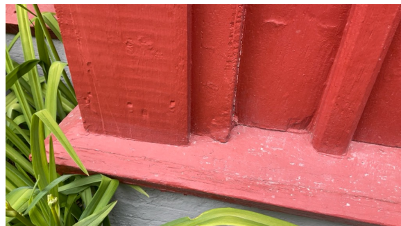
Noe råte i kledning.
