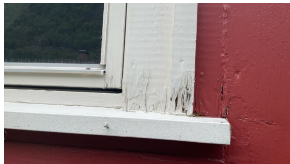
Noe begynnende råte i sidebelistning på vinduer.
