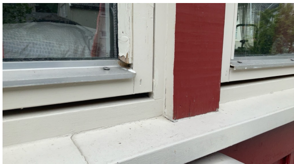
Manglende åpning ned mot vannbrett.
