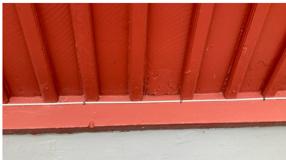
Manglende glipe i nedre kant av kledning mot bunnlist.
