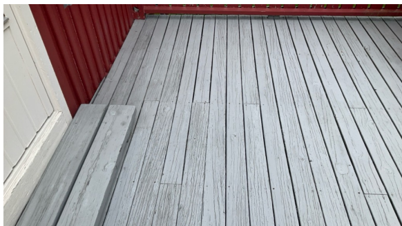
Noe tidsmessig slitasje på terrassegulv.
