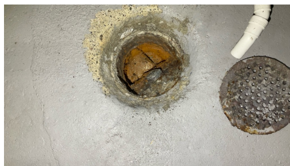
Sluk med rust.
