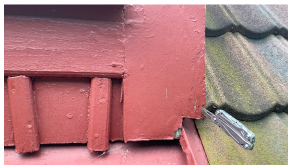
Råte i hjørnebelistning på takoppløft.
