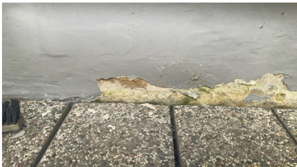
Løs puss/løs maling på grunnmur
