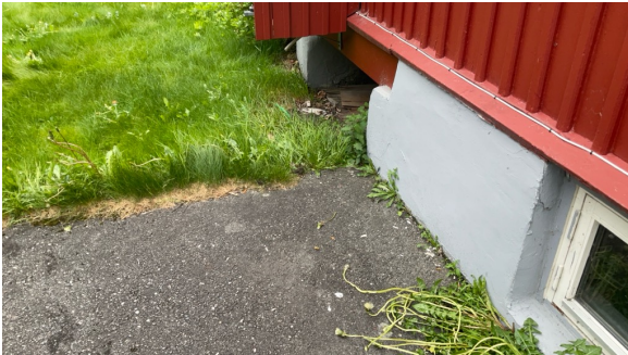
Lokalt fall mot grunnmur under varmepumpe.
