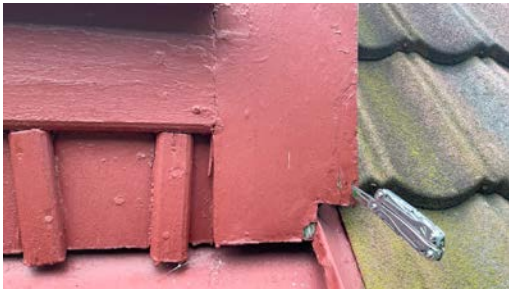
Råte i hjørnebelistning på takoppløft.
