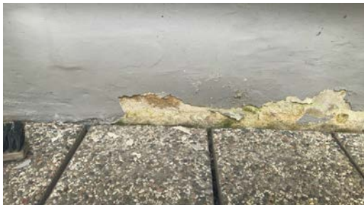
Løs puss/løs maling på grunnmur
