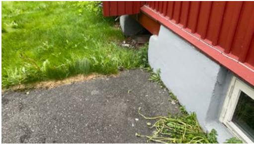
Lokalt fall mot grunnmur under varmepumpe.
