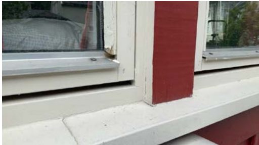
Manglende åpning ned mot vannbrett.
