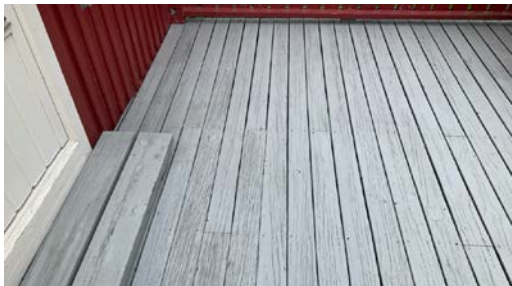
Noe tidsmessig slitasje på terrassegulv.
