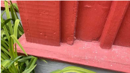
Noe råte i kledning.
