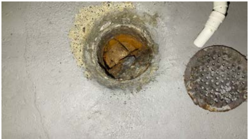
Sluk med rust.
