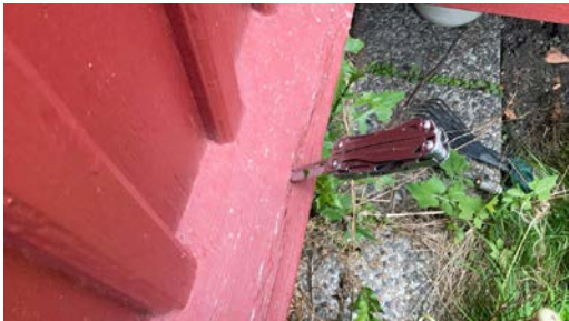
Råte i bunnlist.
