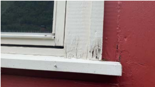
Noe begynnende råte i sidebelistning på vinduer.
