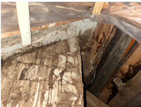
Fuktskjolder rundt pipe.
