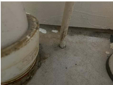
Ikke tettet rundt rørgjennomføring.
