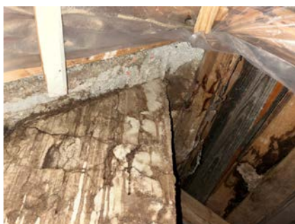
Fuktskjolder rundt pipe.
