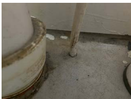
Ikke tettet rundt rørgjennomføring.
