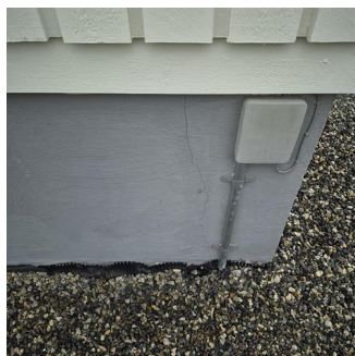
Grunnmur og fundament - Riss/sprekker grunnmur 2
