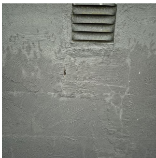
Grunnmur og fundament - Riss/sprekker grunnmur 1
