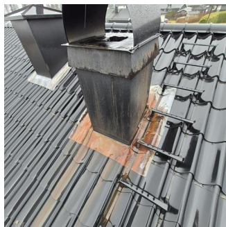
Skorsteiner (over tak) - Slitasje fotbeslag skorstein
