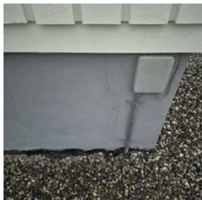
Grunnmur og fundament - Riss/sprekker grunnmur 2
