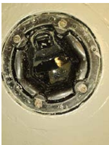
Tettesjiktets tilslutning til sluk - Sluk vaskerom
