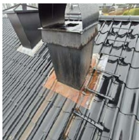
Skorsteiner (over tak) - Slitasje fotbeslag skorstein
