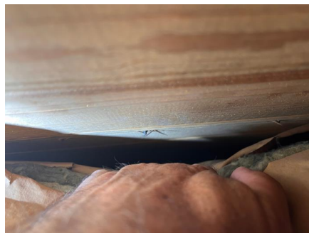
Ikke lufting mellom bordtro og isolasjon.
