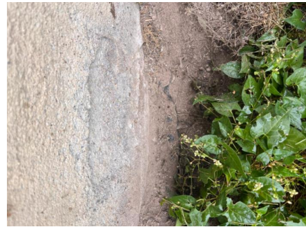
Vorteplast under terreng, ikke avsluttet med toppliste
