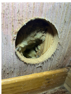
Synlig fukt på innside av veggplate under trapp
