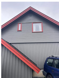
Enkelte sprekker på kledningen på nordvegg.
