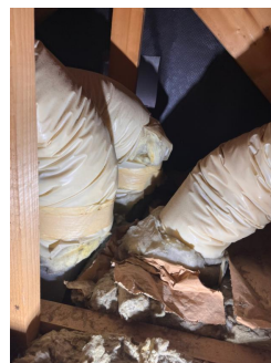
Noe svakt/dårlig isolert rundt rørgjennomføringer i himling.
