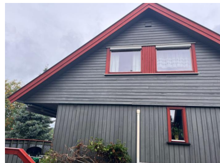
Mye sprekker og slitt kledning på sørvegg
