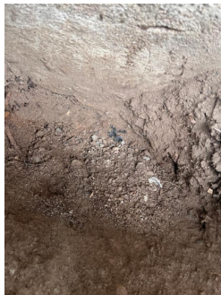
Vorteplast under terreng, ikke avsluttet med toppliste
