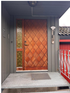
Døren har behov for overflatebehandling
