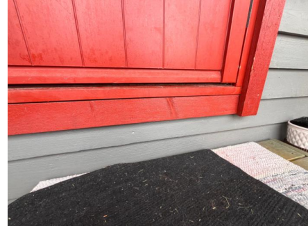
Det er ikke montert beslag under balkongdøren.
