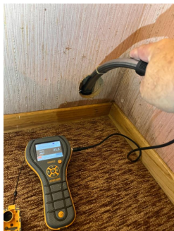
Fuktkontroll med pigger i svill i vegg under trapp.
