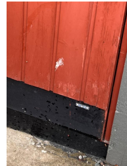
Døren har behov for overflatebehandling
