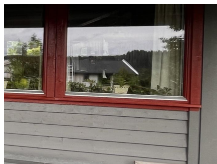
Ingen luftespalte mellom vannbrett og underkant vindu
