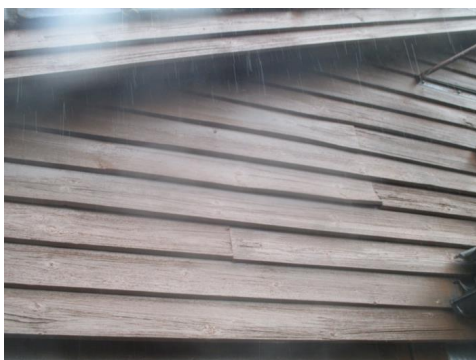
Soltørket og værslitt kledning.
