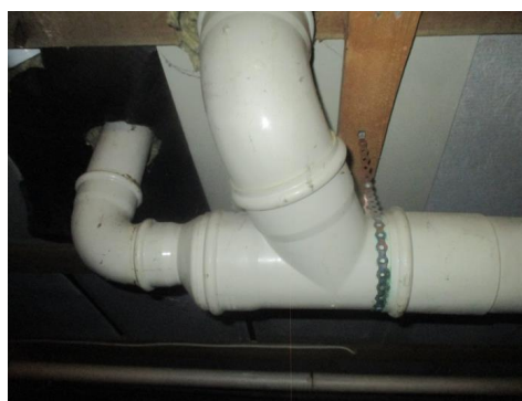
Avløpsrør i grovkjeller.
