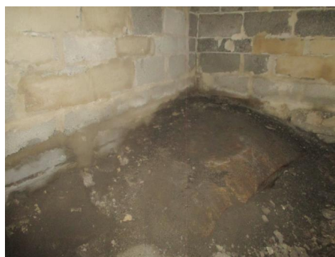
Kommer inn et fjell i hjørne av grovkjeller.
