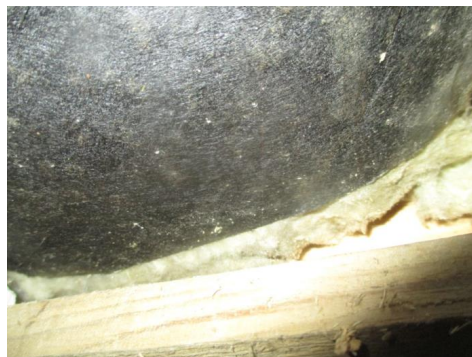
Fuktmåling i underliggende himling i grovkjeller.
