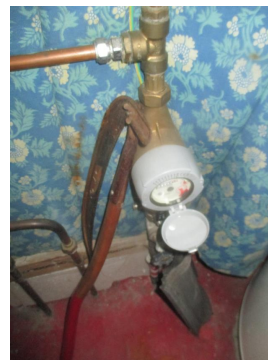
Innvendig stoppekran med vannmåler.
