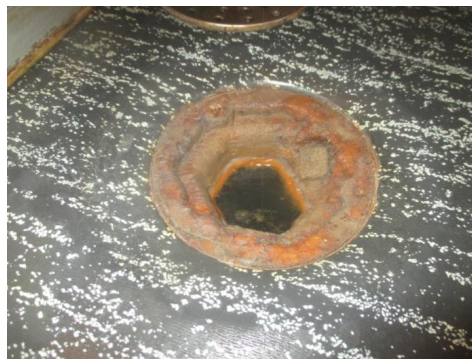
Eldre opprinnelig sluk.
