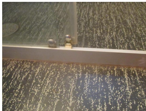
Høy tett oppkant i mot dusj.
