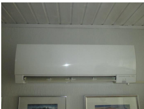
Varmepumpe i stue.
