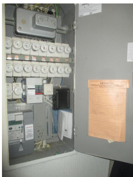
Sikringsskapet er plassert i entre.
