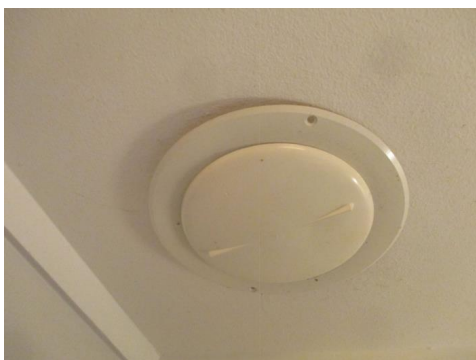
Ventil i himling med naturlig avtrekk.
