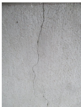
Noen mindre sprekker og riss i grunnmuren.
