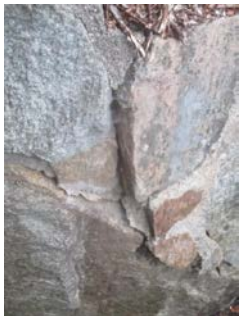
Sprekk i forstøtningsmur ved garasje.
