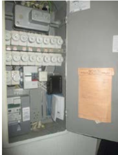
Sikringsskapet er plassert i entre.
