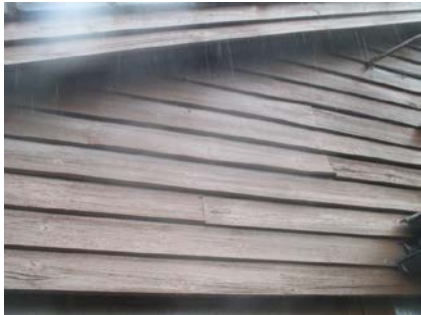
Soltørket og værslitt kledning.
