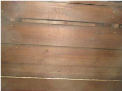
Bra med lufting i gesimser.
