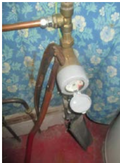
Innvendig stoppekran med vannmåler.
