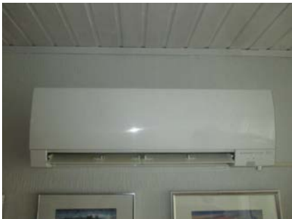
Varmepumpe i stue.
