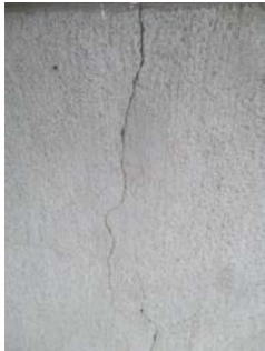
Noen mindre sprekker og riss i grunnmuren.
