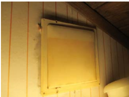
Ventil i ytterveggen.
