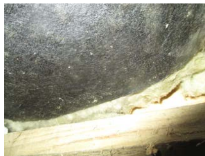
Fuktmåling i underliggende himling i grovkjeller.
