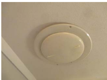
Ventil i himling med naturlig avtrekk.
