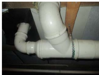
Avløpsrør i grovkjeller.
