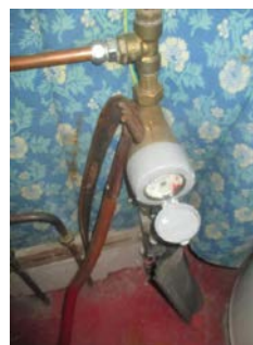
Innvendig stoppekran med vannmåler.
