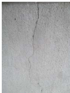
Noen mindre sprekker og riss i grunnmuren.
