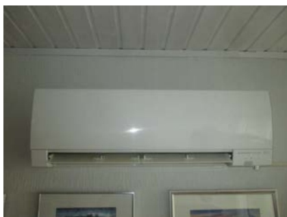
Varmepumpe i stue.
