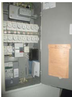
Sikringsskapet er plassert i entre.
