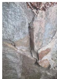
Sprekk i forstøtningsmur ved garasje.
