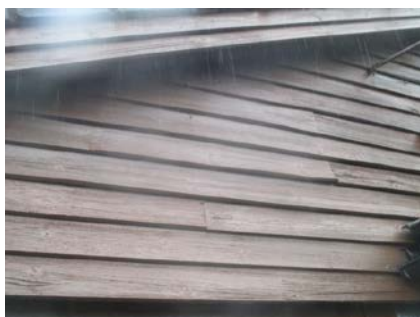
Soltørket og værslitt kledning.
