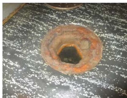
Eldre opprinnelig sluk.
