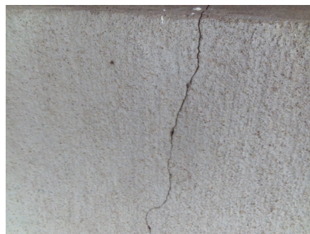
Noen mindre sprekker enkelte steder.
