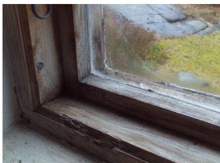
En del kondensmerker på ubehandlet vinduer i kjeller.
