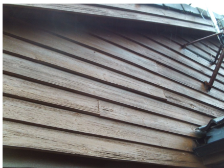
Soltørket og værslitt kledning
