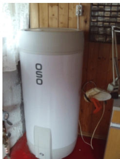
Ny bereder er plassert på verkstedrom.
