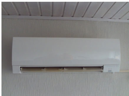
Defekt varmepumpe i stue
