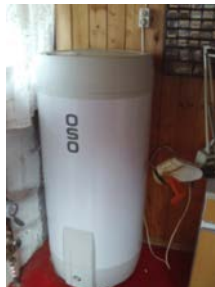
Ny bereder er plassert på verkstedrom.
