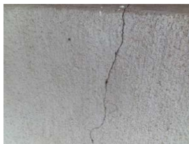
Noen mindre sprekker enkelte steder.
