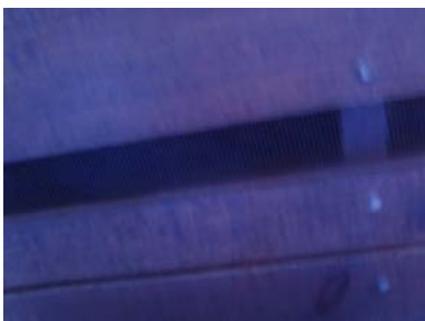
Gode luftespalter i gesimsen.
