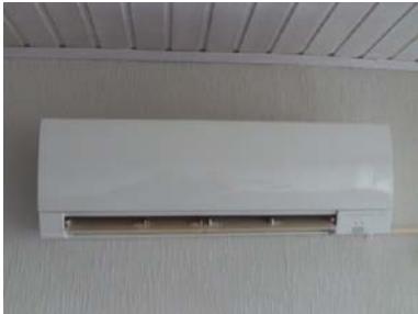
Defekt varmepumpe i stue
