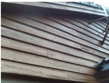
Soltørket og værslitt kledning
