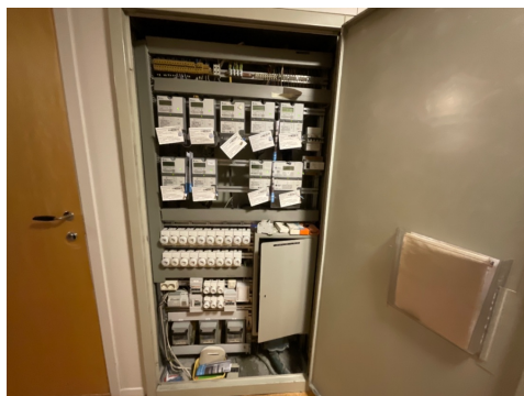
Hoved sikringskapp i fellesgang
