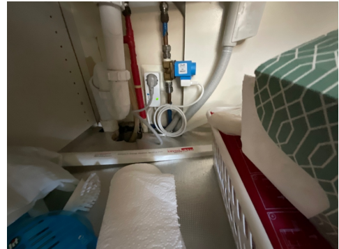
Kobber og plast (rør i rør)
