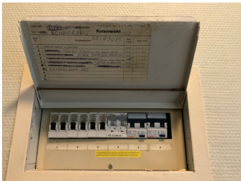
Sikringskapp i entree
