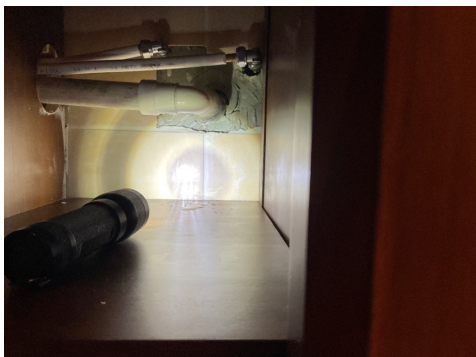
Avløp i servanten på badetrom
