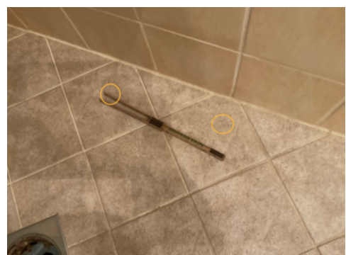
Bom under flis i dusjnische
