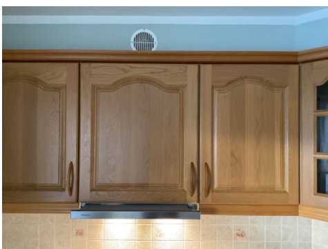
Kjøkkenventilator og utluft over overskap
