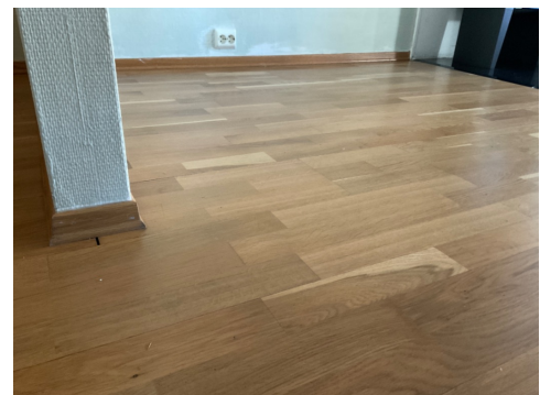
Glipe i gulv og manglende maling.
