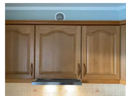
Kjøkkenventilator og utluft over overskap
