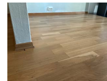
Glipe i gulv og manglende maling.
