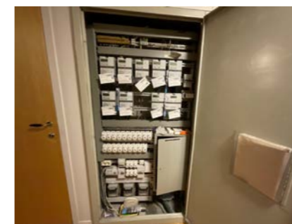
Hoved sikringsskap i fellesgang
