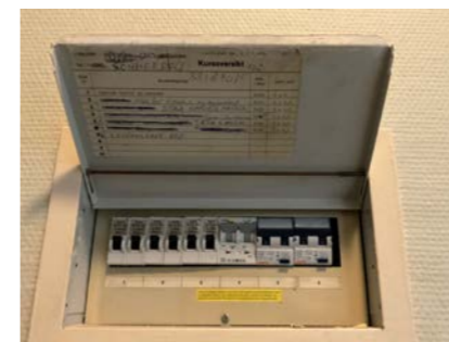
Sikringsskap i entree
