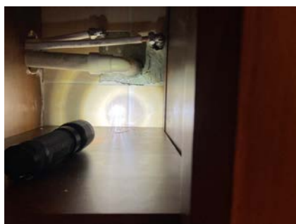
Avløp i servanten på badrom
