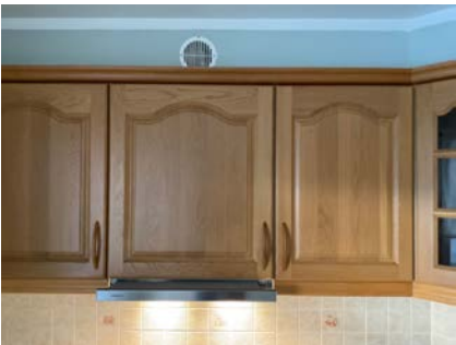
Kjøkkenventilator og utluft over overskap
