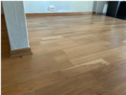
Glipe i gulv og manglende maling.
