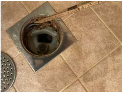
Sluk på baderom
