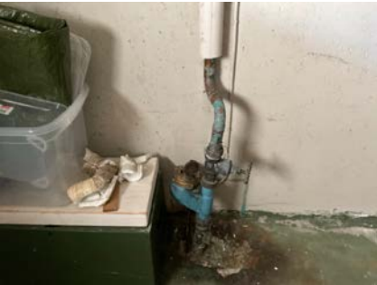
Hovedstoppekran for bygningen
