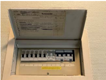
Sikringsskap i entree
