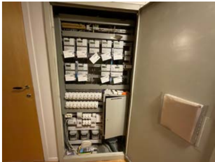
Hoved sikringsskap i fellesgang
