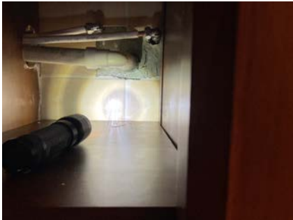
Avløp i servanten på badetrom
